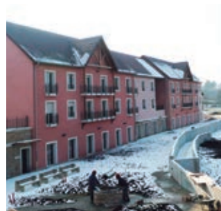
Sanatorium Montcenis. Přes 6 100 m 2 a 85 pokojů. Saône et Loire, Francie. ECO-G
